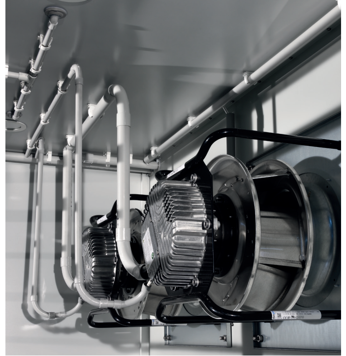
Şekil 22. Güç ve sinyal kablo boruları
